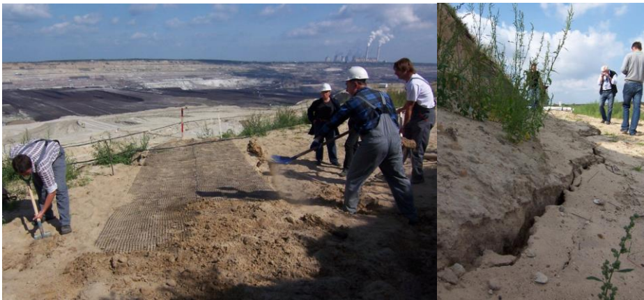
Rys.4 Instalacja geosiatki pomiarowej z zintegrowanym sensorem POF na terenie Kopalni Węgla Brunatnego Bełchatów
